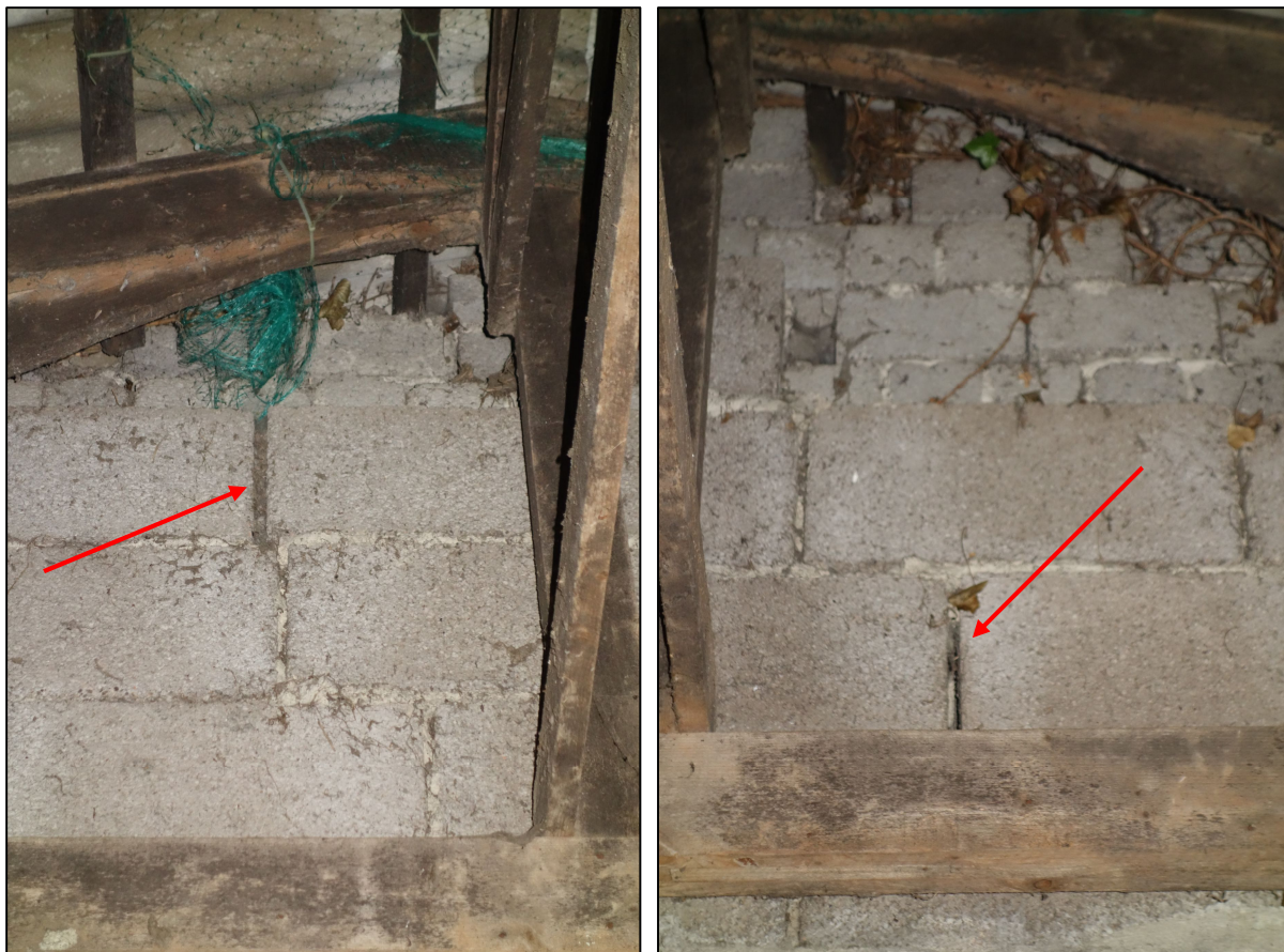
Abbildung 9 und 10: potentielle Spaltquartiere in offenen Mauerfugen an der Innen-Nordwand (Foto: ALSE 21.12.2020)
